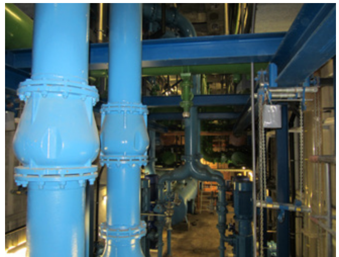
Bild 2: Technische Ausrüstung in der Grundwasseraufbereitungsanlage (GAA)
