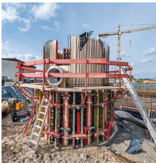
Das wird einmal der sogenannte Tiefsandfang
