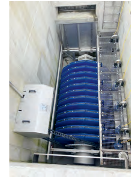
Blick auf einen Tuchfilter der vierten Reinigungsstufe der Kläranlage Mörfelden-Walldorf.
