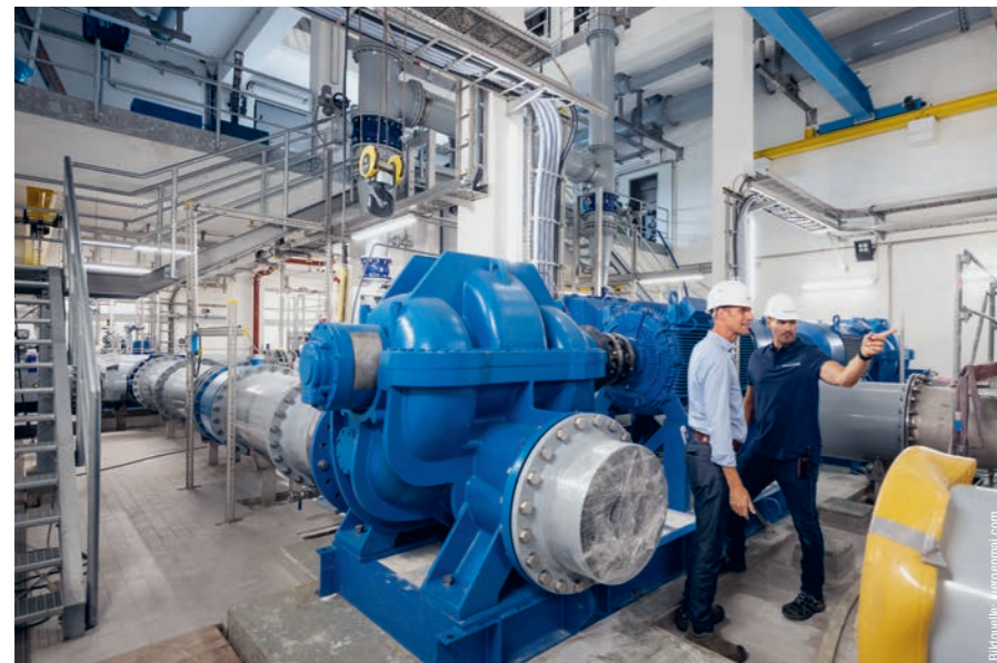
Blick ins Wasserwerk Allmendfeld mit neuer Pumpe.
