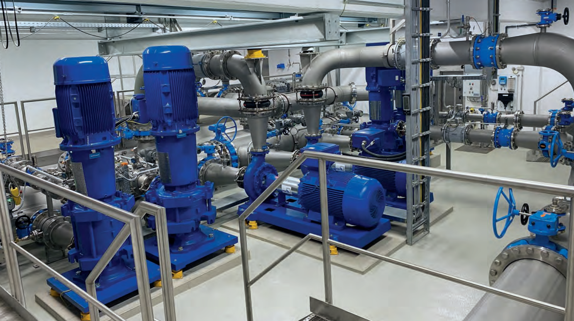
Neue Druckerhöhungsanlage mit einer Leistungsfähigkeit von 1.200 m 3 pro Stunde und einem Netzdruck von 5,2 bar
