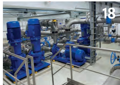
Hessenwasser hat den Zweckverband „Wasserwerk Gerauer Land“ bei der Auslegung einer neuen Pumpenanlage beraten – und zusätzliche Effizienzpotenziale gehoben.
